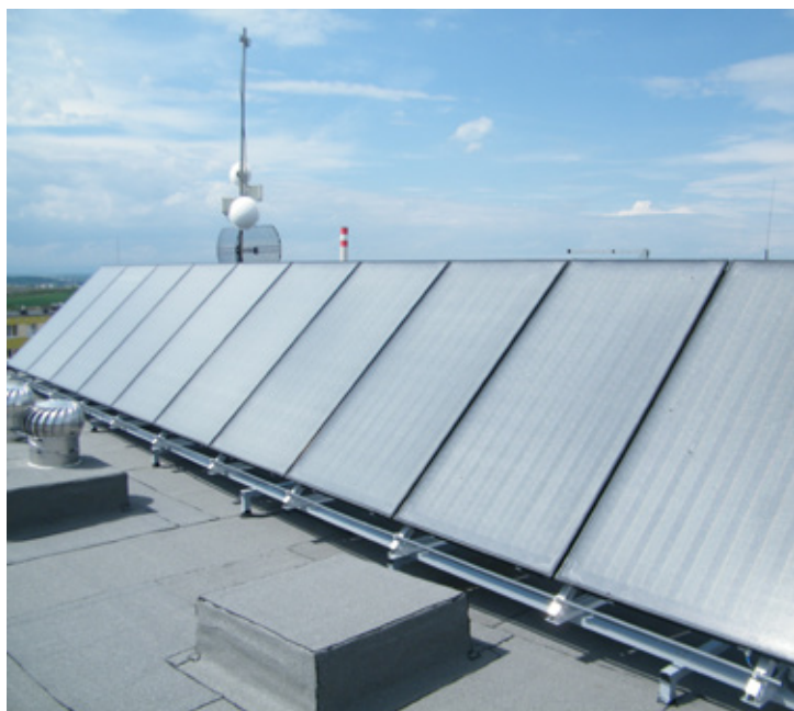
Obr. 2: Solární kolektory Logasol SKN3.0 na ploché střeše domu
