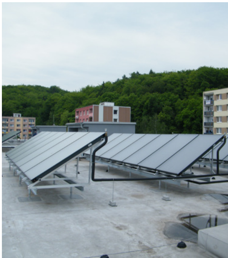
Obr. 6: Solární kolektory na bytovém domě
